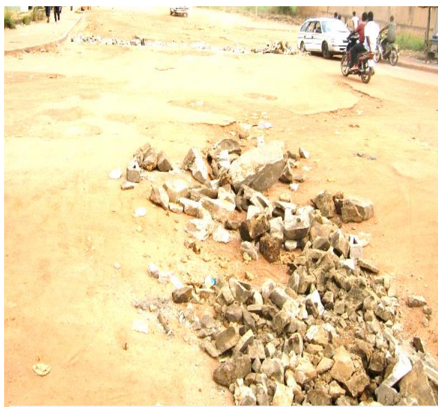
Photo 30 : Dégradation de l'axe principal entre la Grande Mosquée et la DRT à Mô Faitai (Image d'archive 2009)
