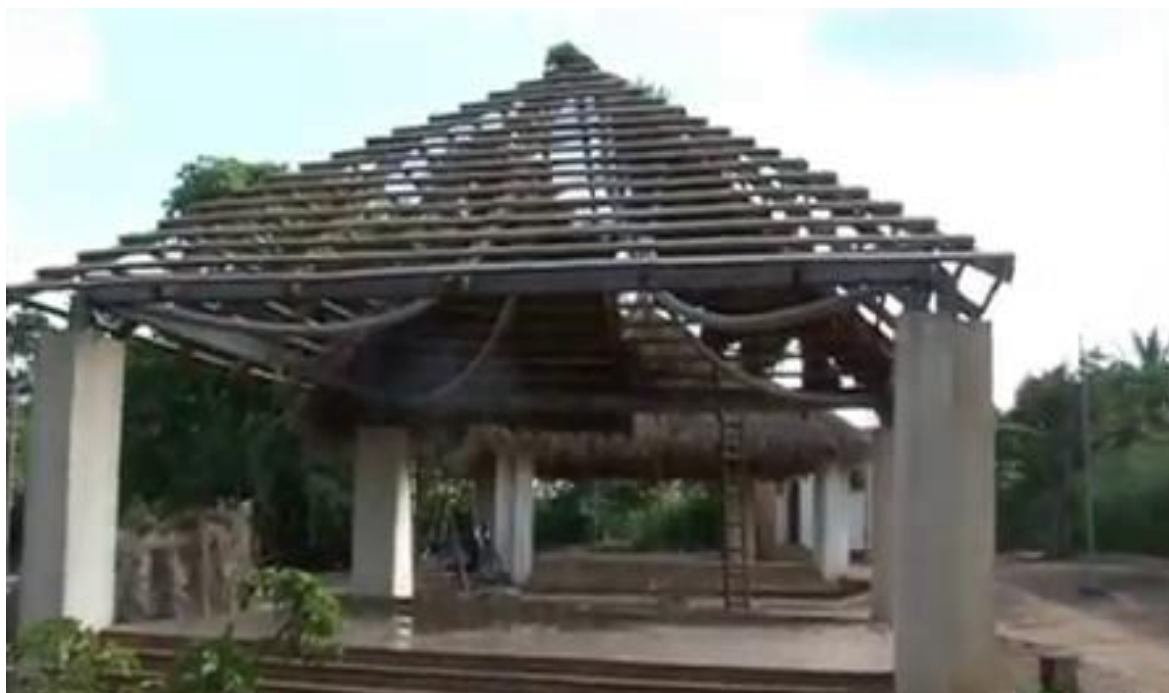
Photo 31 : Un hangar de repos en ruine à la plantation urbaine "Guiglo" de Yamoussoukro (KONAN O., 2016)
